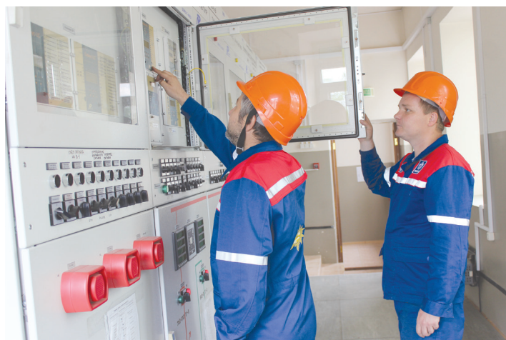
Проверка параметров блока защиты элегазового выключателя силового трансформатора № 1 в дальнейшем обеспечит своевременную ликвидацию аварийных режимов работы питающего центра в столице республики
